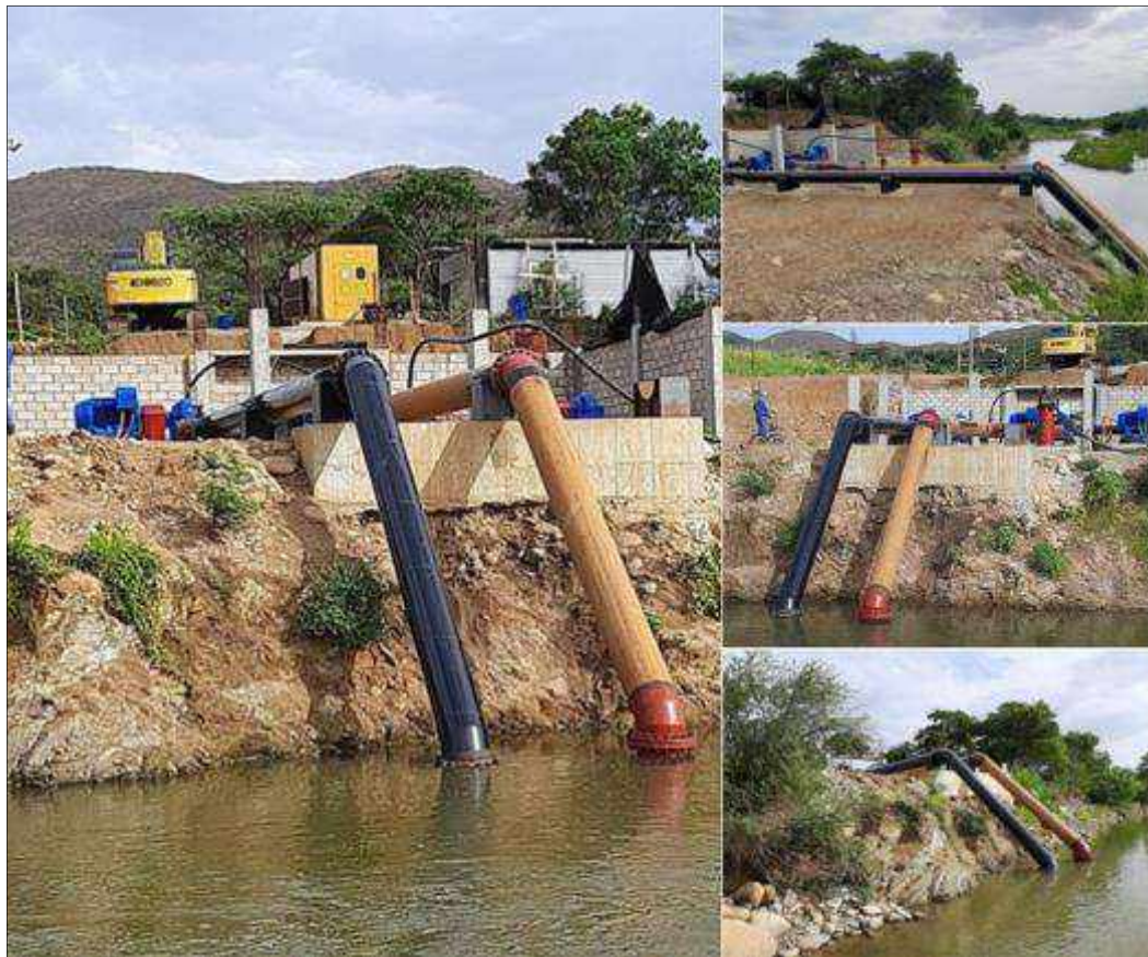
Captación Cercana (de Emergencia / coordenadas 7°50'32"N - 72°31'02"W)
