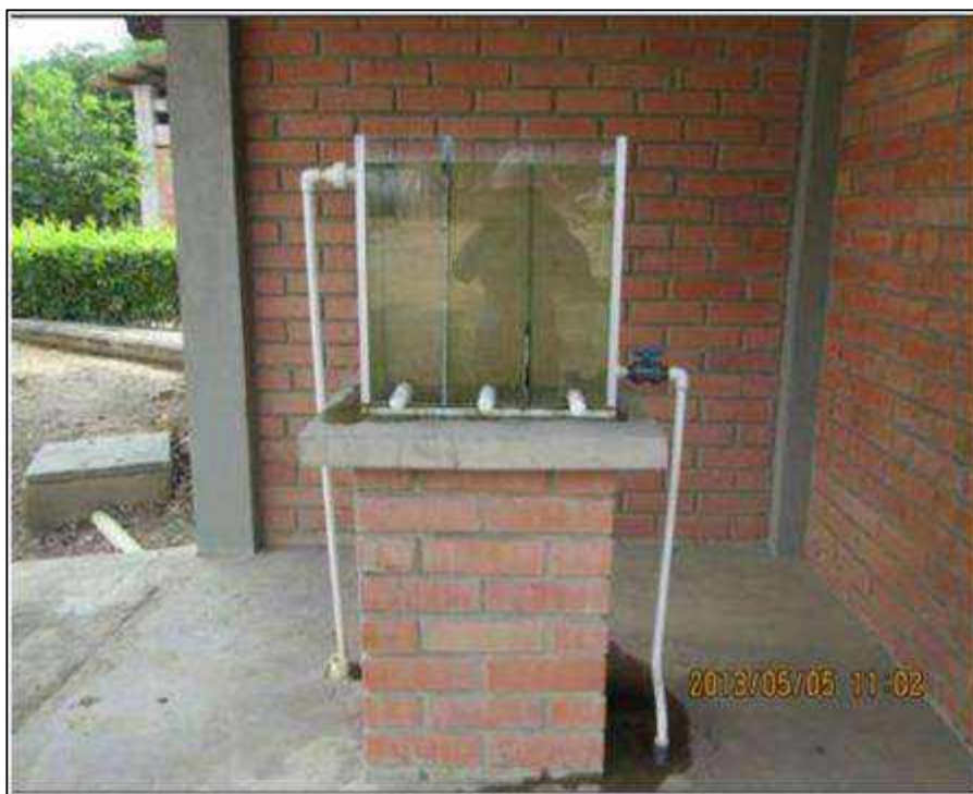
Imagen 037: Sistema Bioalarma Pamplonita Plata de Tratamiento de Agua Potable (PTAP) ubicado en la vereda El Pórtico
