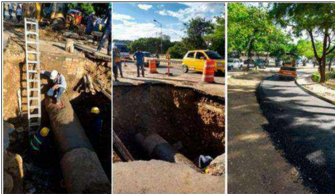
ROTURA DE TUBERÍA MATRIZ DE 30" – Diagonal Santander – 2017-10-19
