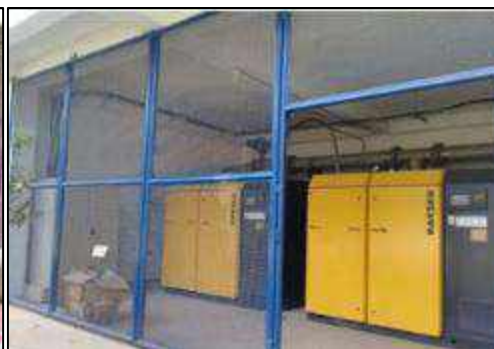
Sopladores para el lavado de filtros
