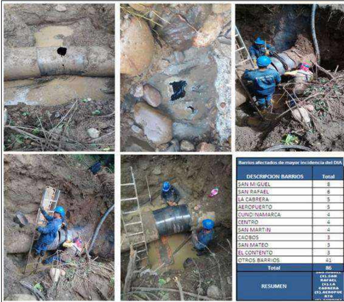
ROTURA DE TUBERÍA MATRIZ DE 30" CCP – Sector del Batallón – Grupo Maza – 2019-06-28
